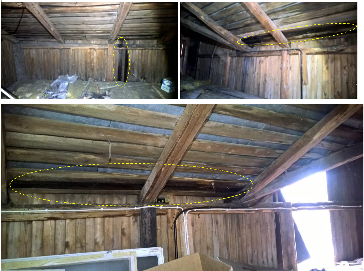
Kuva 12. Sateisen kelin takia vuotokohtia voitiin paikallistaa puuosien värin perusteella.
