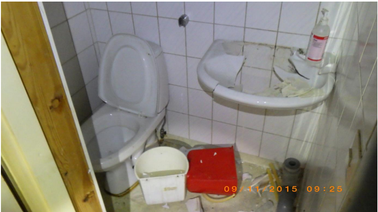
Kuva 4. Rakennuksen sisätilat oli tuhottu.
