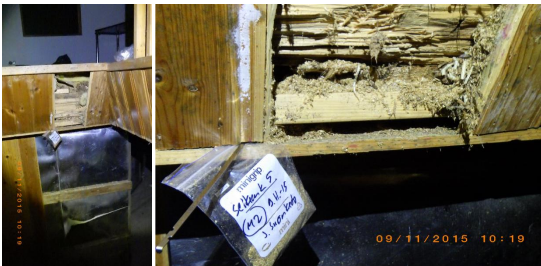
Kuva 7. Näyte M2 otettiin rakennuksen itäpäädyn porrasaukon kohdalta. Analyysin mukaan näytteessä todettiin selkeästi viitearvot ylittävää erittäin runsasta homekasvua. Lajistossa oli mukana kohtalaisena pitoisuutena kosteusvaurioindikaattorina ja mahdollisena toksiinien tuottajana pidettyä homelajia. Tulos osoitti välipohjan mikrobivaurioitumista.
