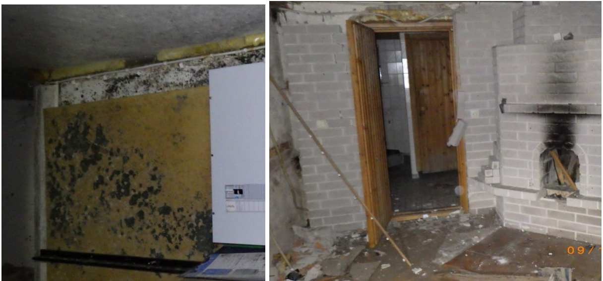
Kuva 2. Kellarikerroksen kaikki pinnat olivat homeessa ja niitä on rikottu polttopuiden saamiseksi.
