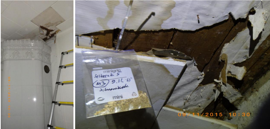
Kuva 8. Näyte M2 otettiin rakennuksen keskeltä savuhormin juuresta näkyvästä vuotokohdasta. Analyysin mukaan näytteessä todettiin viitearvot ylittävää runsasta homekasvua. Lajistossa oli mukana pienenä pitoisuutena kosteusvaurioindikaattorina pidettyä homelajia. Tulos osoitti yläpohjan mikrobivaurioitumista ainakin vuotokohdista.
