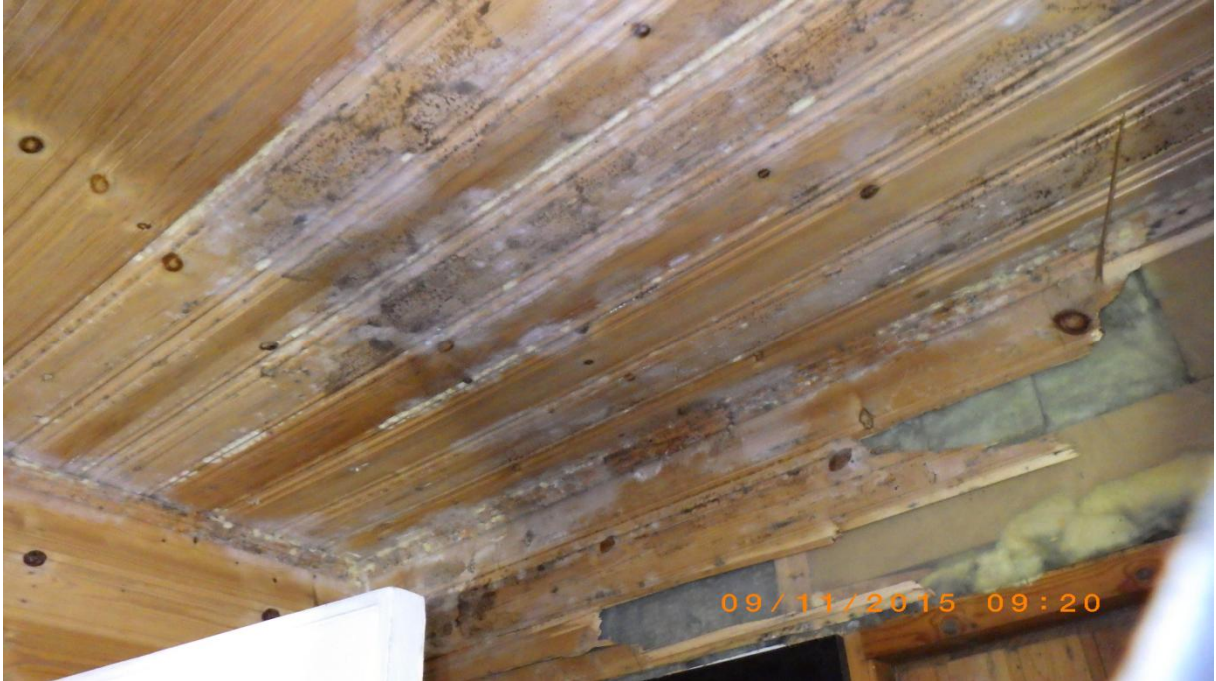
Kuva 3. 1. kerroksen eteistilojen katossa oli poikkeuksellisen runsasta homekasvua. Tämä viittaa vuotoihin kuistin kattojen liittymässä.
