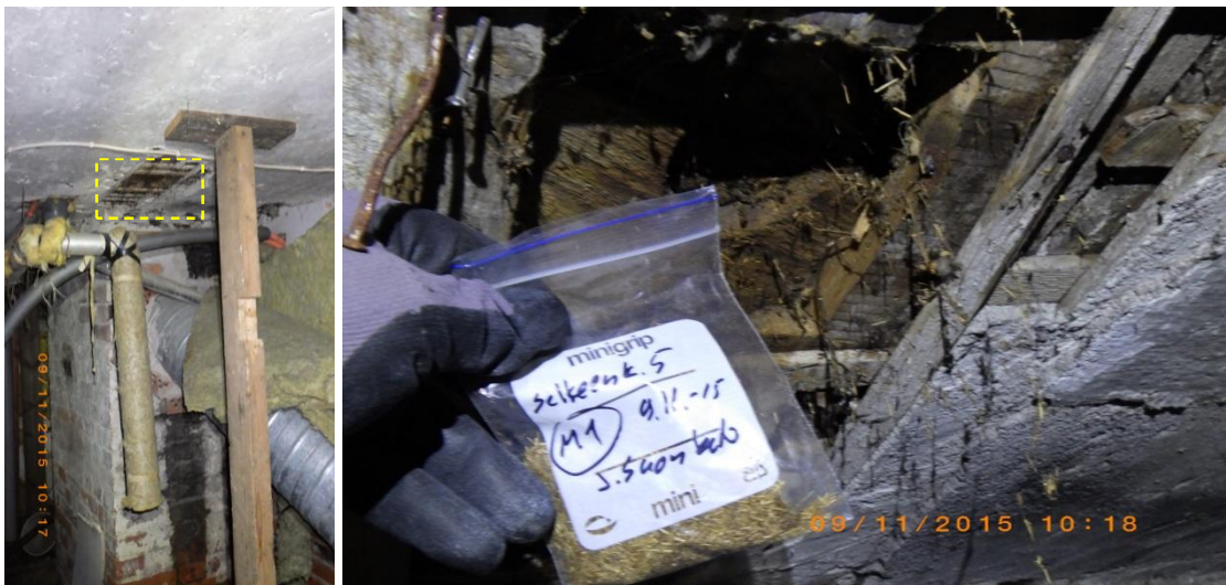
Kuva 6. Näyte M1 otettiin rakennuksen länsipäädystä rossipohjan lämmöneristeistä.. Analyysin mukaan näytteessä todettiin viitearvot ylittävänä runsaana pitoisuutena homekasvua. Lajistossa oli mukana kohtalaisena pitoisuutena kosteusvaurioindikaattorina ja mahdollisena toksiinien tuottajana pidettyä homelajia. Tulos osoitti välipohjan mikrobivaurioitumista.
