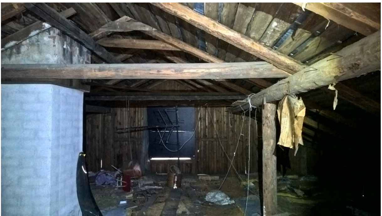
Kuva 10. Ullakkotila on avara ja siellä ei jälkien perusteella ole koskaan ollut edes kesäkäytössä olleita huonetiloja. Nyt ullakkotilassa oli eri-ikäistä romua ja rakennusjätettä, mutta se oli rakennuksen muuhun kuntoon nähden siisti.
