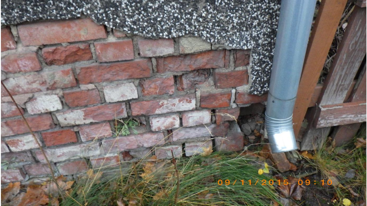
Kuva 1. Perusmuurit ovat poikkeuksellisesti kokonaan tiilirakenteiset. Nurkissa oli havaittavissa pakkasrapautumista, mutta kokonaisuutena ne olivat rakenteellisesti kunnossa.
