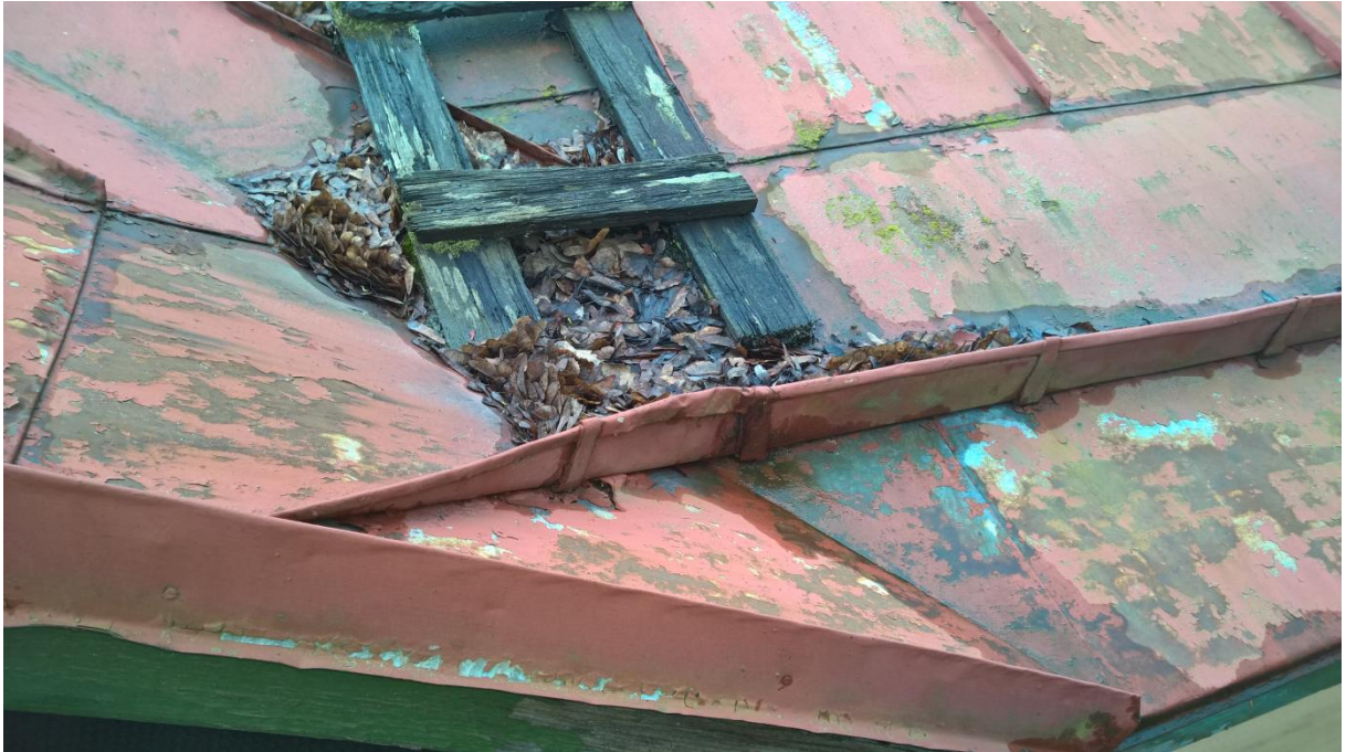
Kuva 13. Kuvan 12 vuotokohta ulkopäin kuvattuna.
